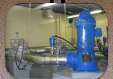
Gestion municipale des services d'eau
