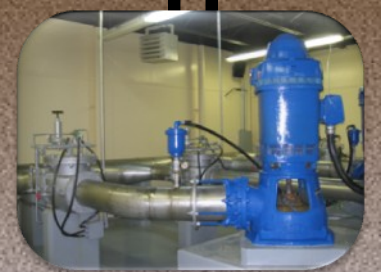
Gestion municipale des services d'eau
